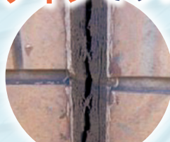
コーキングの ひび割れ
