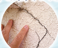
外壁や目地に ヒビ割れがある
